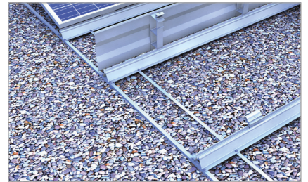
Tasakattojärjestelmä etelä I suljettu sorakatolla
